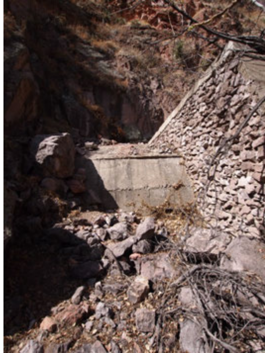
Salida del túnel N° 10, con su extensión para proteger la vía de derrumbes (28-03-2013)
